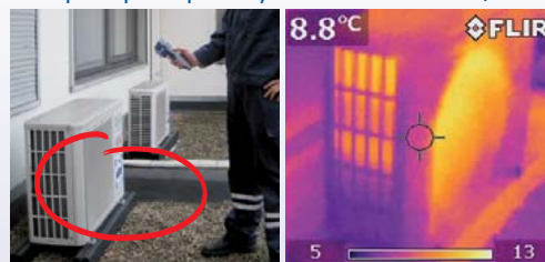
Проверьте работу систем вентиляции и кондиционирования воздуха за считанные минуты.
