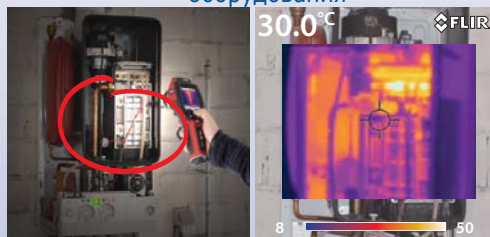
Дефекты установки бытового нагревательного прибора четко видны благодаря функции "картинка в картинке". Тепловизоры FLIR i-серии единственные ИК камеры в своем классе, оснащенные встроенной подсветкой, обеспечивающей высокое качество изображений, вне зависимости от условий освещения.
